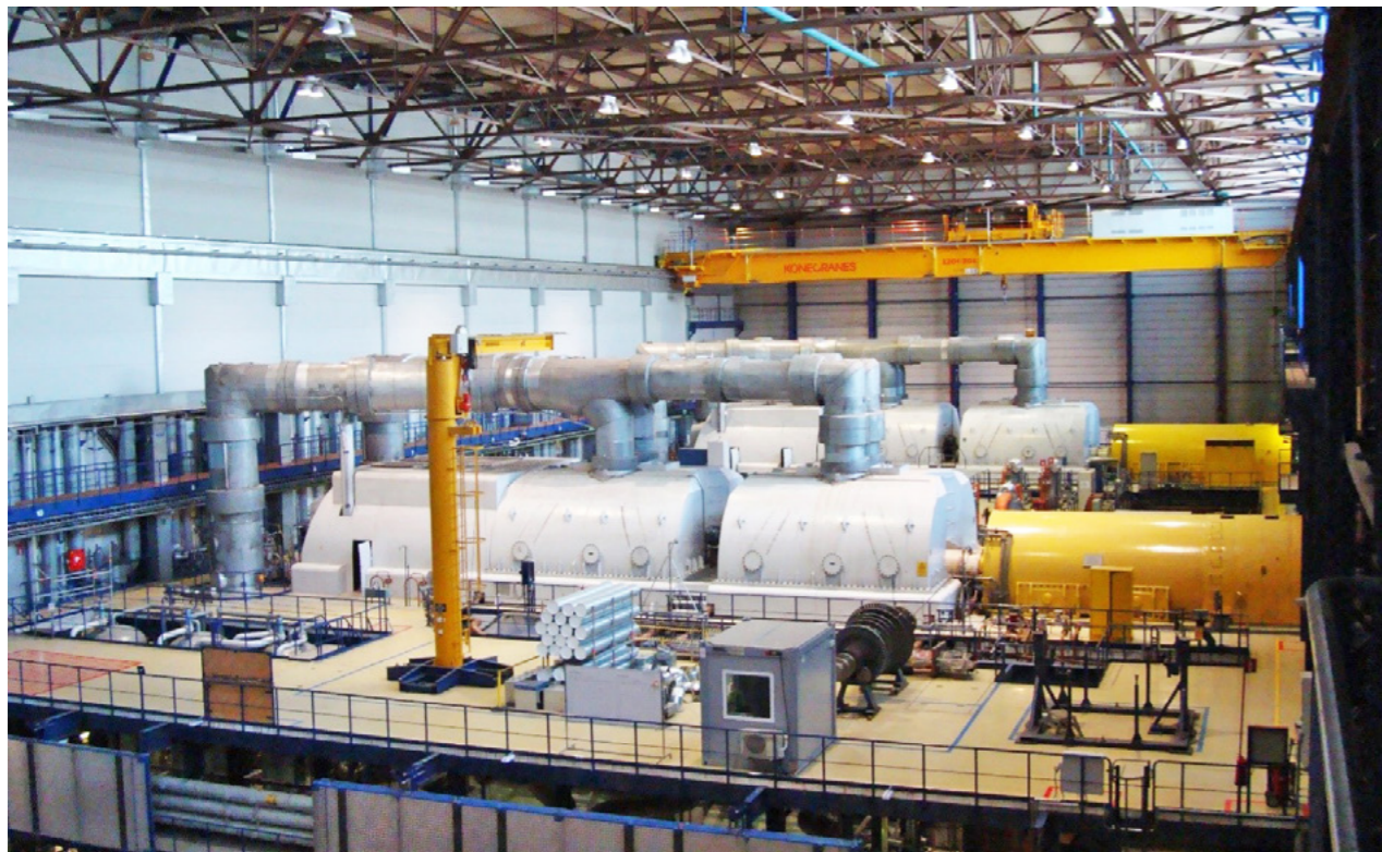
Kuva 5-13. Turbiinirakennus. Kuvassa näkyvät korkeapaineturbiinit ja matalapaineturbiinit sekä generaattorit.
