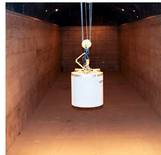
Bild 5-3. Flyttning av avfallsförpackning med solidifierat avfall till betongbassängen i hallen för solidifierat avfall.
