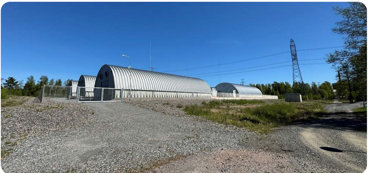
Bild 9. Nuvarande batterienergilagret i området.
