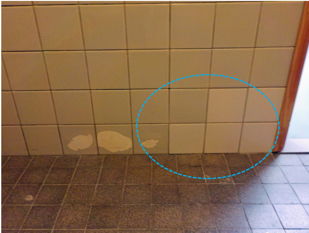
Kuva X. Esimerkki vanhasta vedeneristeen paikkakorjauksesta, jonka yhdessä myös laattoja on uusittu. Korjauksella käyttöikää on jatkettu muutamia vuosia, mutta kuvassa pesuhuoneen kokovaltainen uusiminen on kuitenkin tulossa ajankohtaista. Kuva: P. Annila, Rakennusinsinööri-toimisto Petri Annila
