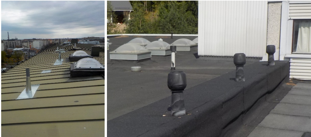
Kuva X. Esimerkkejä vesikatteen paikkakorjauksista peltikatolla ja bitumikermikatolla. Korjaustarve on ollut selkeästi rajattavissa pieneen osaan kattoa. Kuvat: P. Annila, Rakennusinsinööri-toimisto Petri Annila
