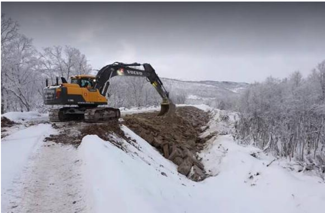
Kuva 5: Alkaen vuodesta 1950 kohti 1980-lukua rakennettiin pitkin Juovlajohka/Julelva-jokea useita suuria tulva- ja eroosiosuojauksia. Seurauksena oli veden virtauksen nopeutuminen ja merinieriän kasvu- ja kutualueiden supistuminen. Kuvassa näkyy eroosiosuojauksen rakentamista kauemmas nykyisestä joen uomasta. Näin joen pinta-ala kasvaa, joten virtausnopeus laskee ja merinieriän kasvu- ja kutualueet ennallistuvat.
