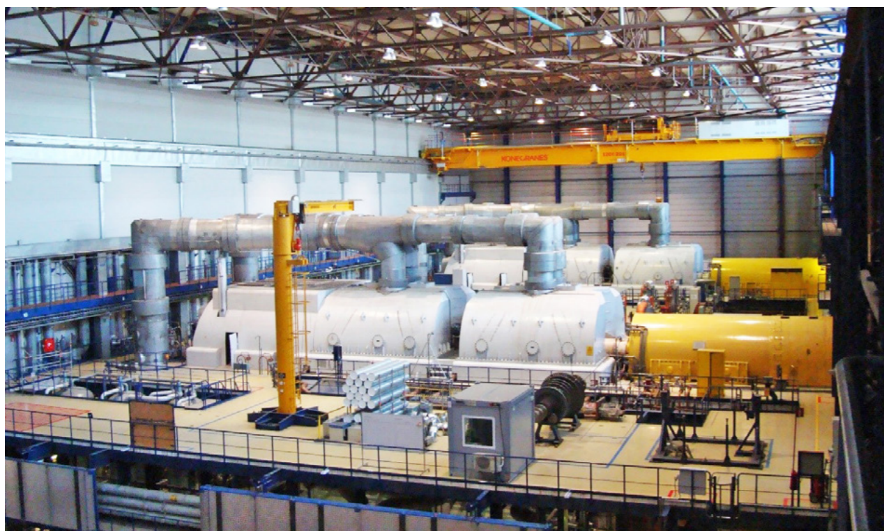
Bild 5-13. Turbinbyggnaden. På bilden visas hög- och lågtrycksturbinerna samt generatorerna.
