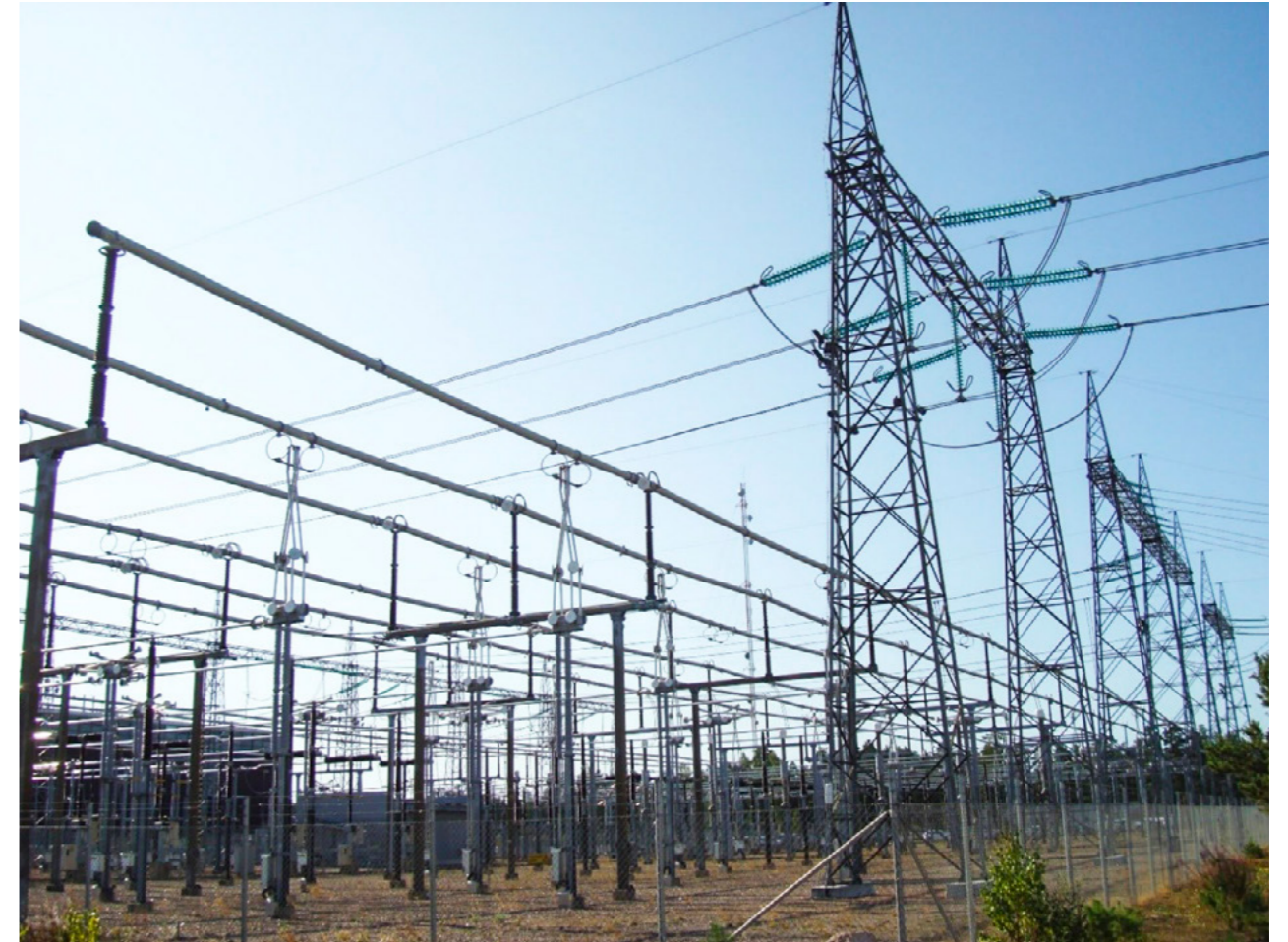
Bild 5-15. Lovisa kraftverks ställverk.
